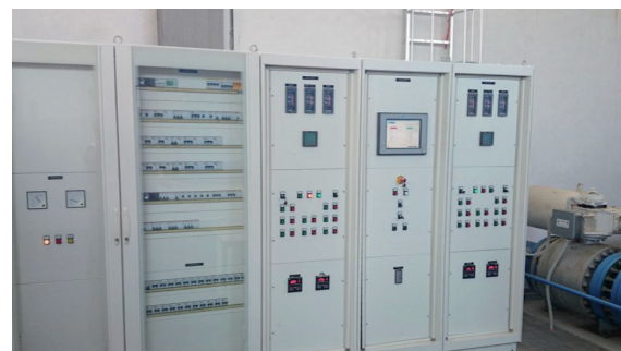
Fig.9: Centrale idroelettrica Agghiastro. Particolare dei quadri di controllo e protezione
