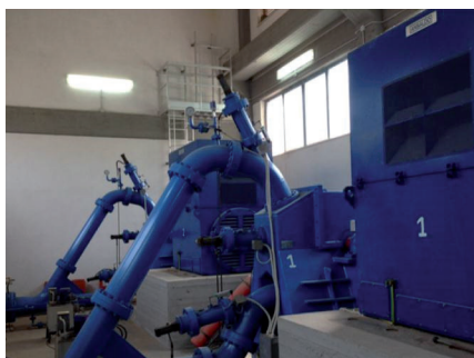
Fig.7: Centrale idroelettrica Agghiastro. Gruppi di produzione idroelettrica
